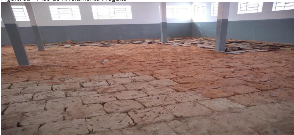
Figura 52 - Piso de nivelamento irregular
