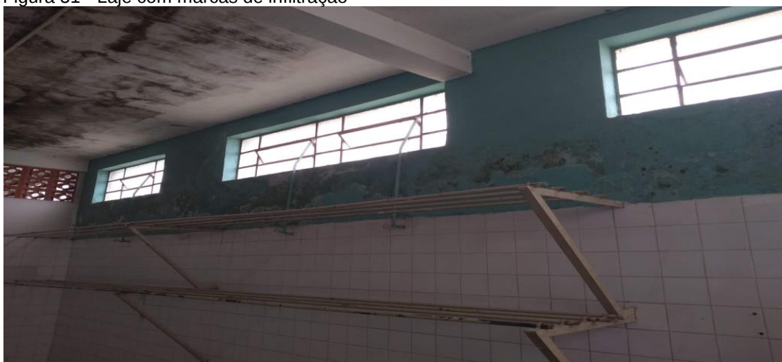
Figura 51 - Laje com marcas de infiltração
