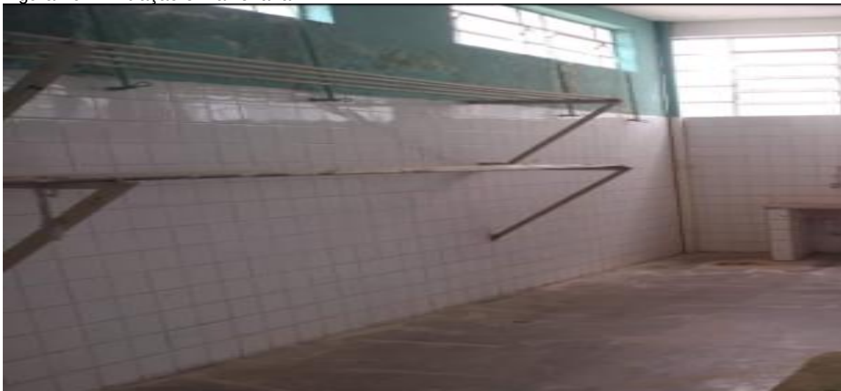
Figura 46 - Infiltração em alvenaria
