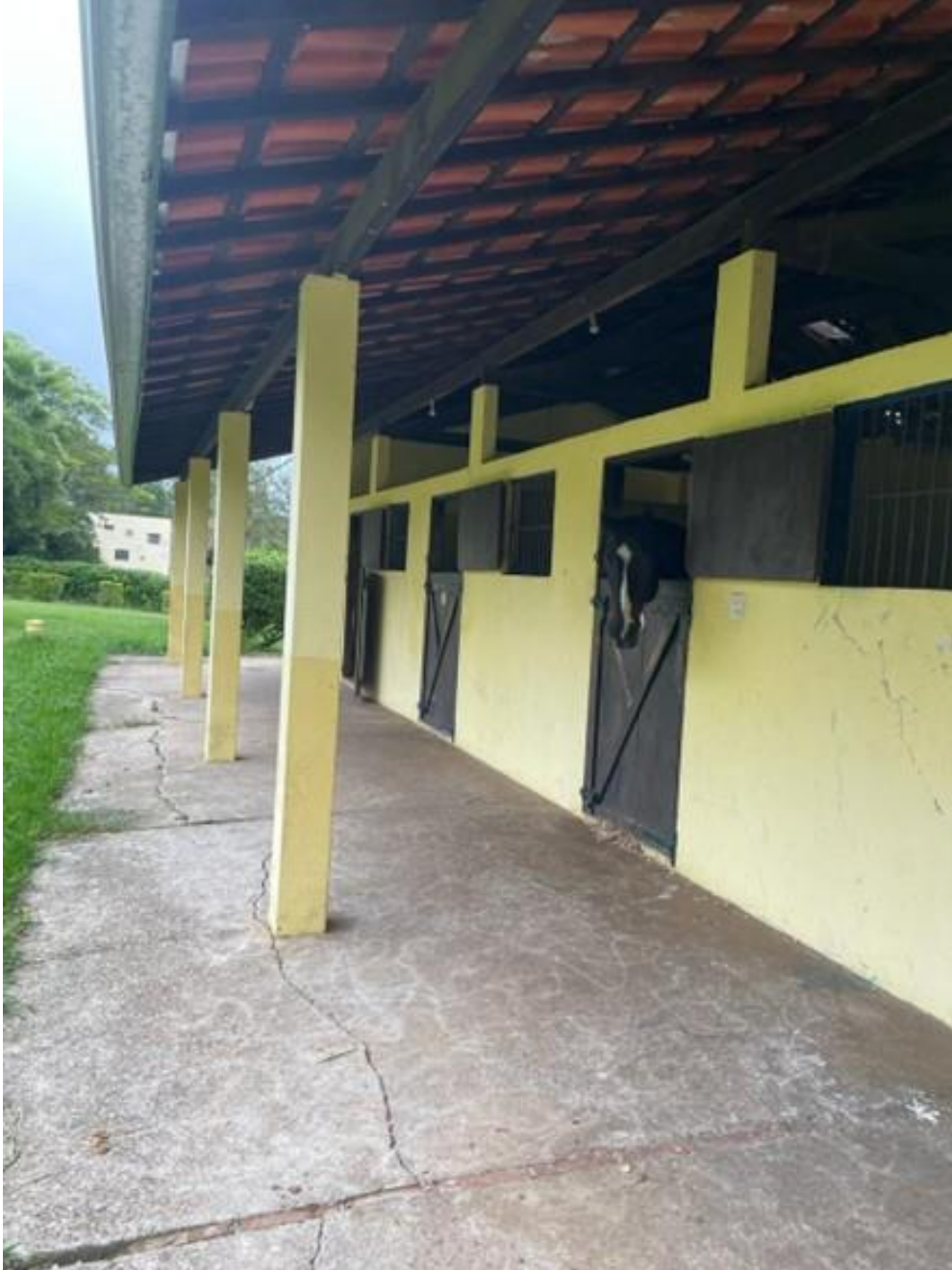
Figura 4. Baias de internação com 19 compartimentos, cada uma equipada com portas de madeira para socialização, cocho para água e cocho para concentrado e volumoso.
