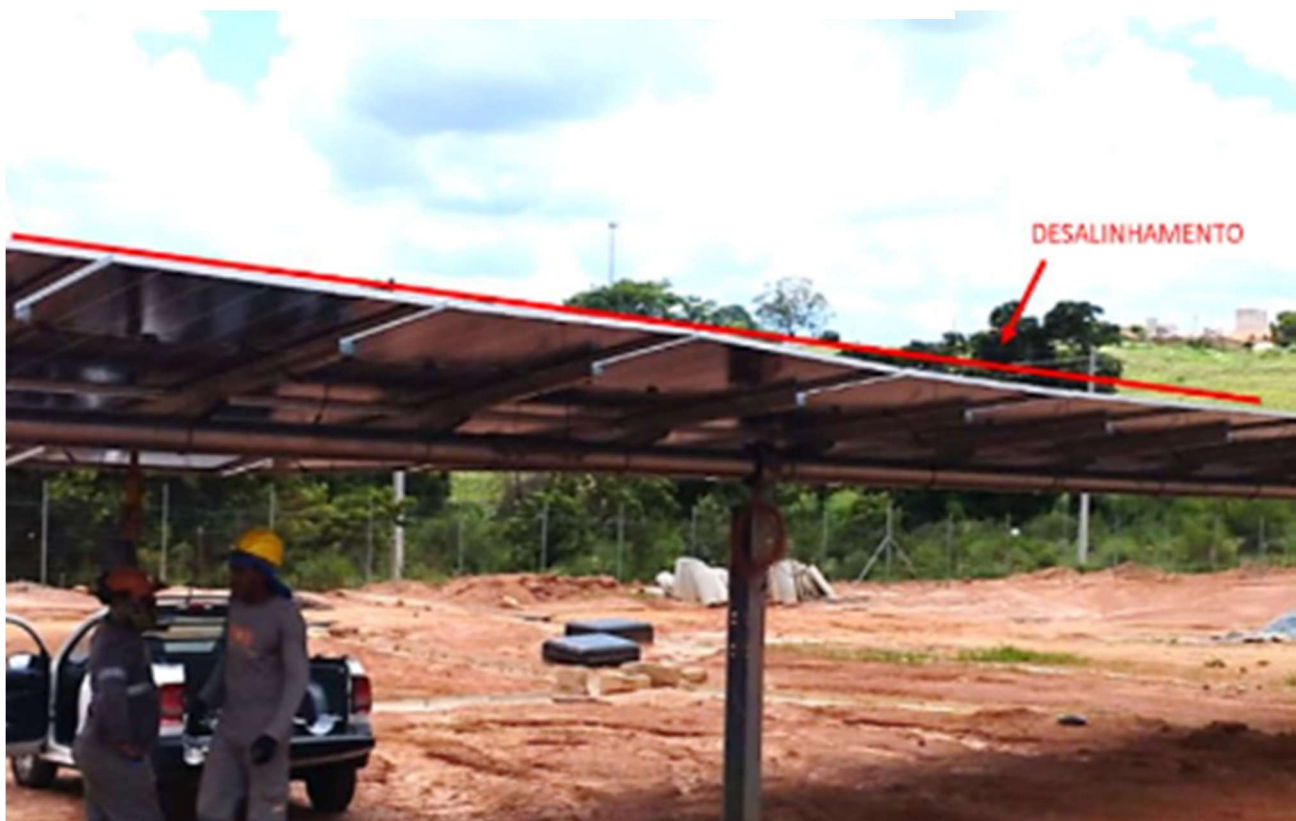
Figura 3 - Desalinhamento da estrutura
