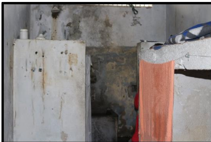
FIGURA 6: Paredes da cela em péssimas condições de conservação
