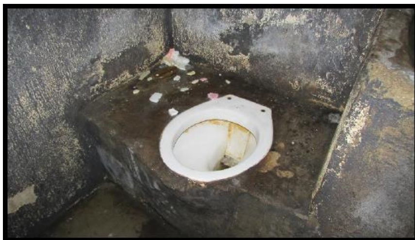
FIGURA 5: Vaso sanitário das celas
