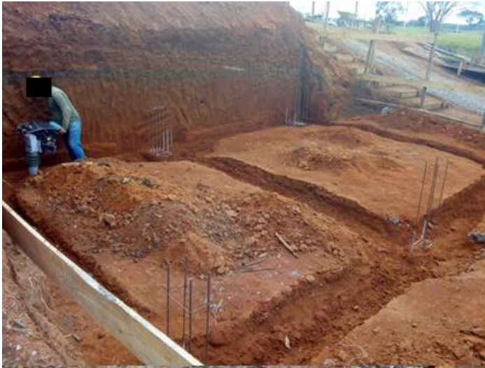
Figura 53 - Compactação do solo
