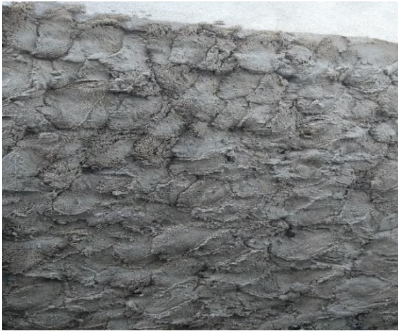
Figura 27- Argamassa na superfície
