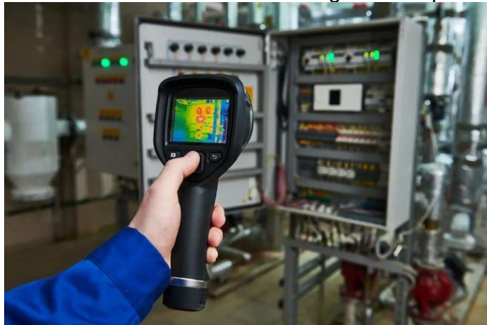
Figura 29 - Termovisor em análise termográfica de painel elétrico
