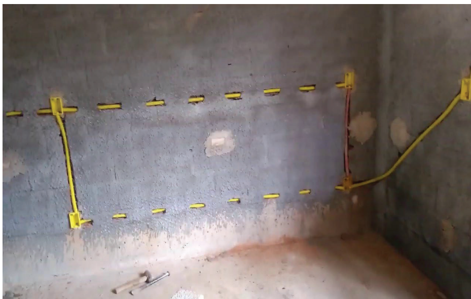
Figura 7 - Eletrodutos e caixinhas nas paredes
