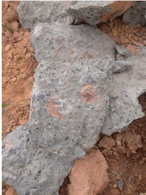
Figura 87 - Concreto com impurezas
