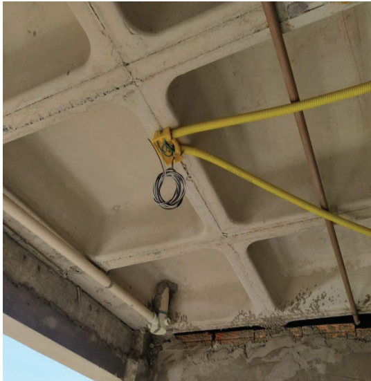
Figura 3 - Eletrodutos e caixas de passagem já instalados
