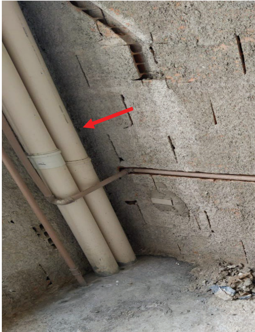
Figura 18 - Tubos de queda
