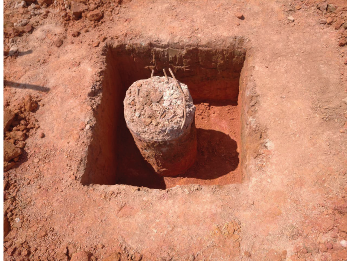
Figura 85 - Estaca parcialmente exposta
