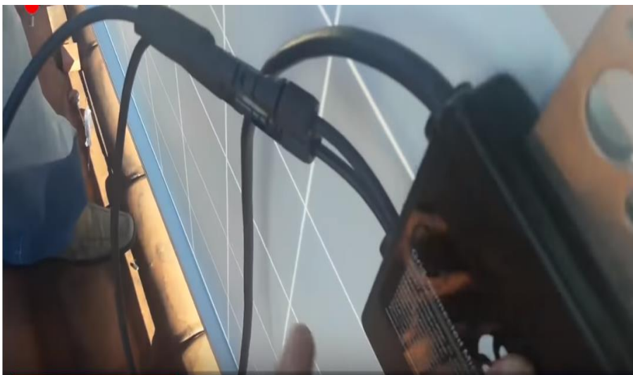
Figura 59: Cabos conectados ao micro-inversor
