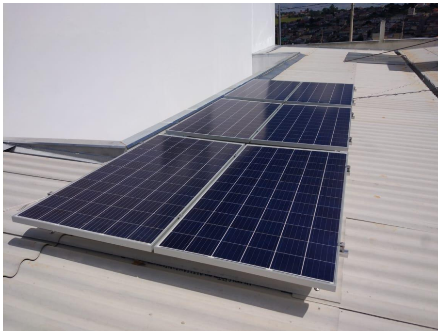
Figura 56: Módulos fotovoltaicos integrados ao telhado
