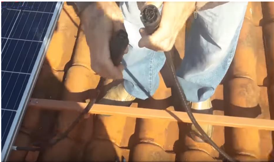
Figura 60: Ligação do cabo que vai para a rede elétrica
