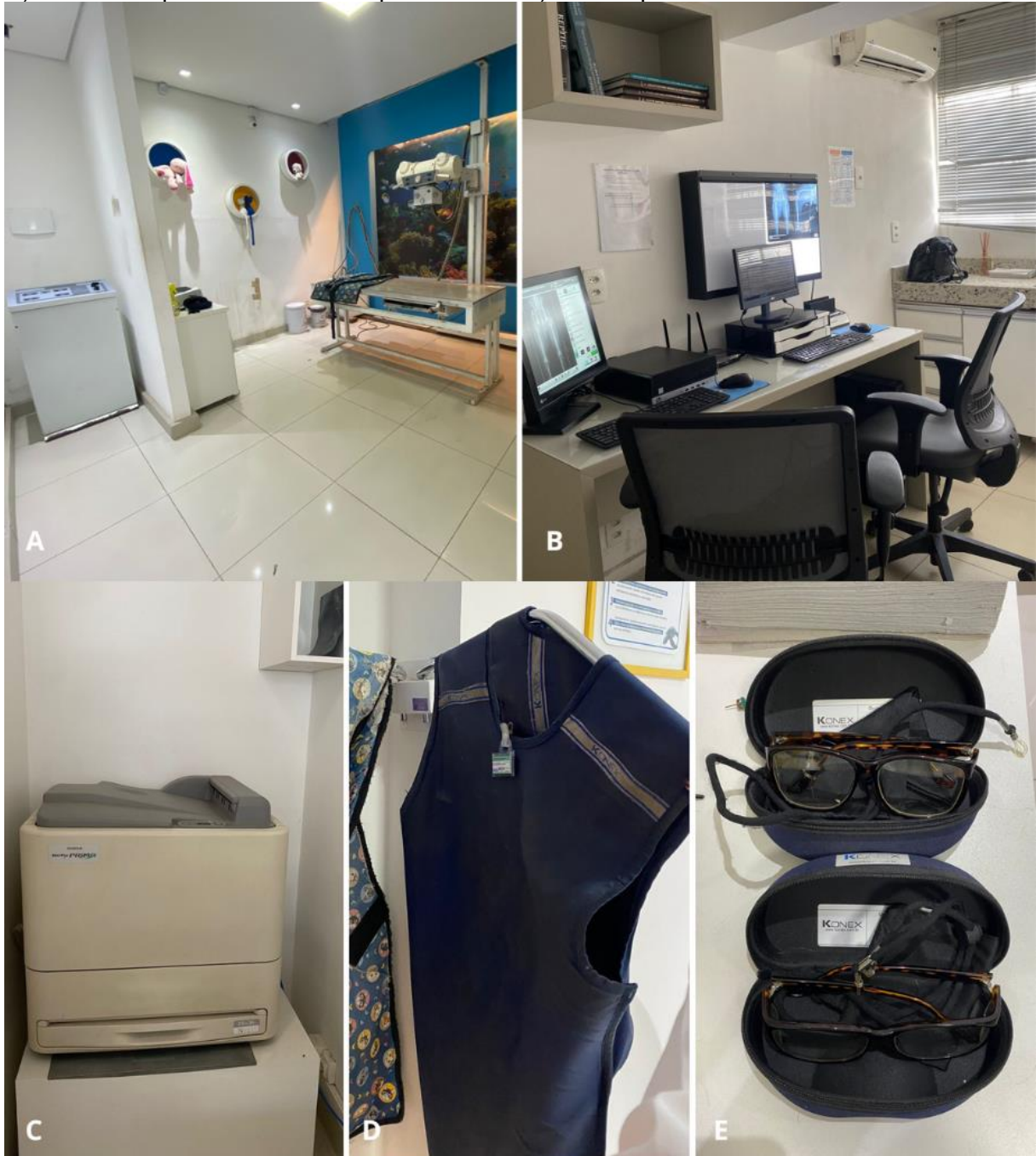
Figura 2: Sala de exames radiográficos. A) Sala de raio-x com transformador a esquerda. B) Computadores para laudos e negatoscópio. C) Processador e revelador dos filmes de raio-x. D) Aventais e protetor de tireoide plumbíferos. E) Óculos plumbíferos.
