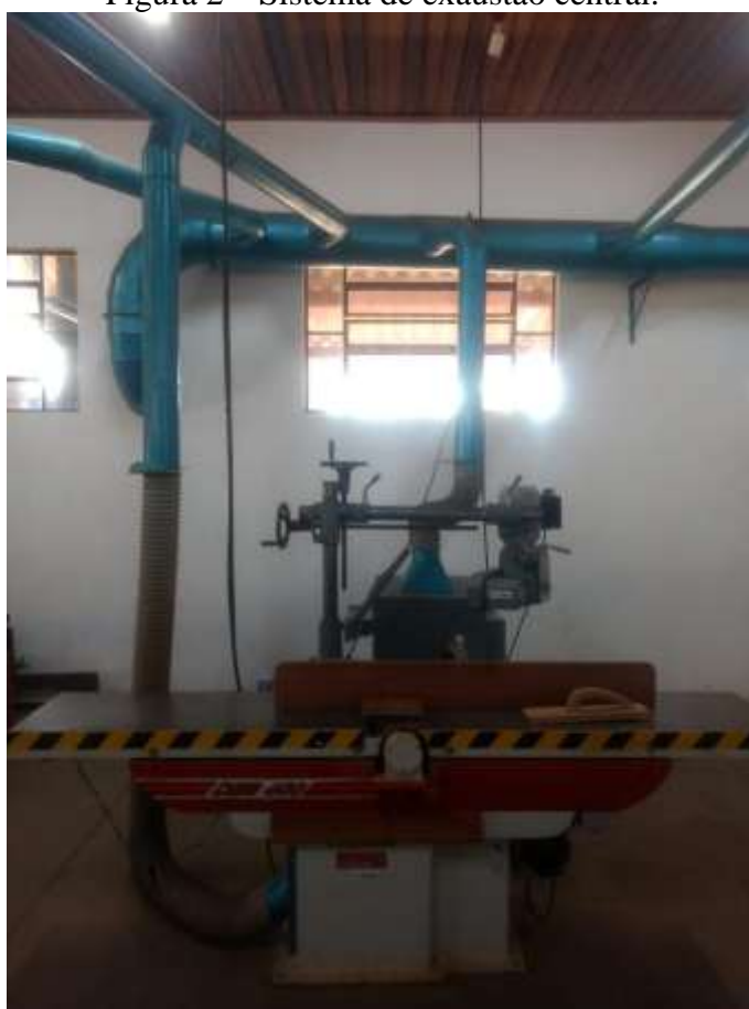
Figura 2 – Sistema de exaustão central.
