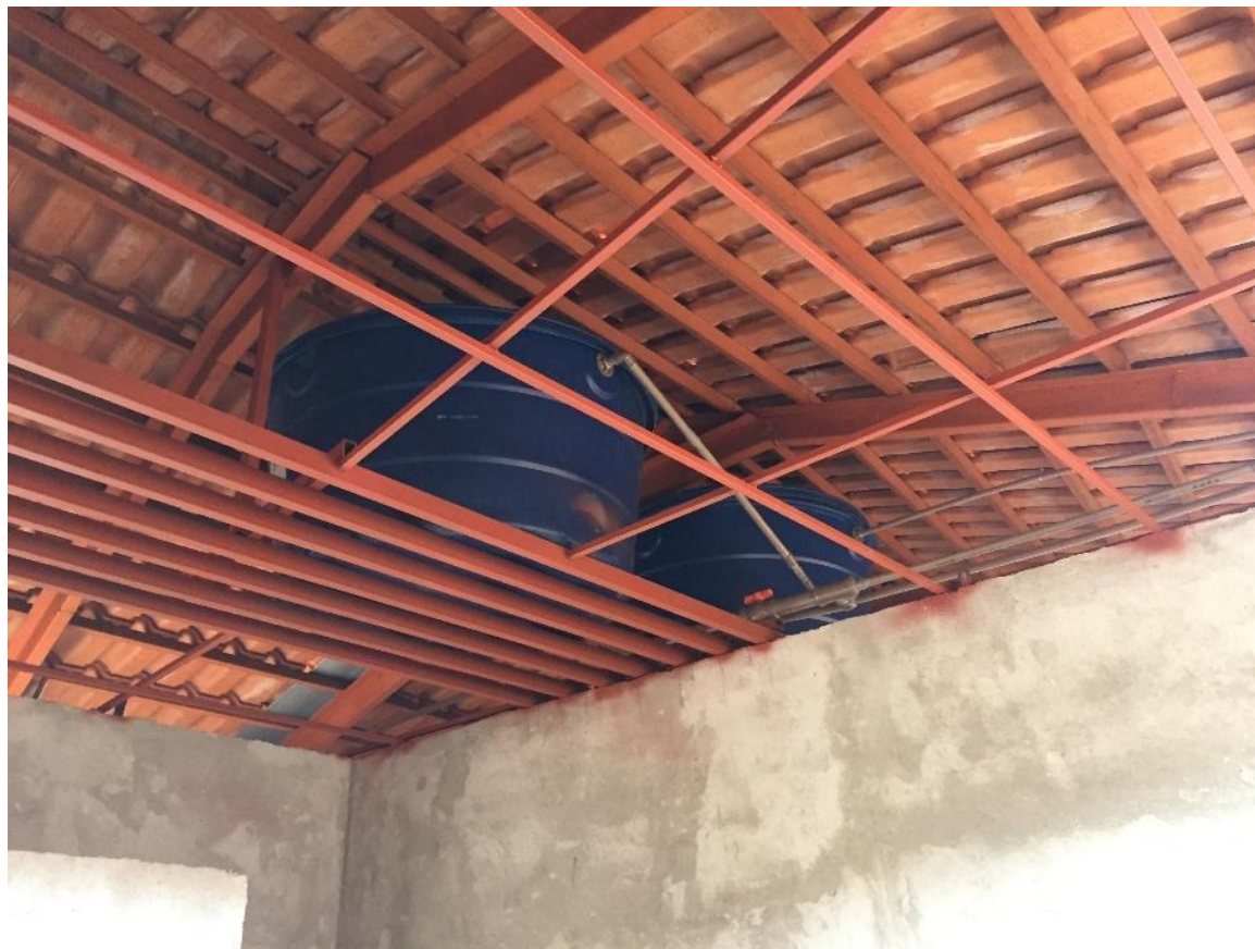
Figura 45 - Sistema de armazenamento de água
