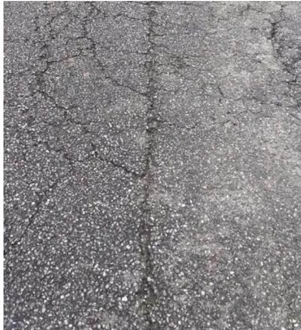
Figura 42 – Deformação na estrutura do pavimento
