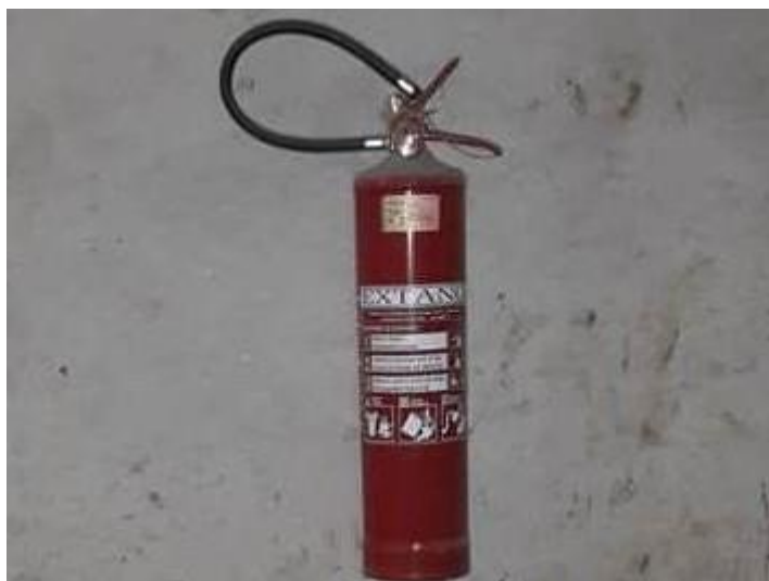
Figura 56 – Extintor de incêndio
