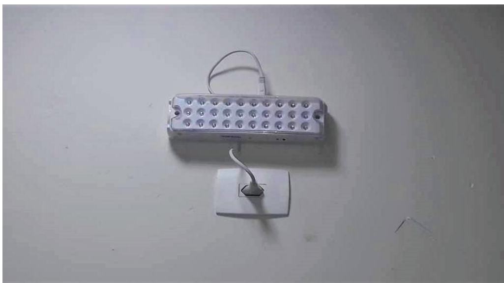
Figura 55 – Iluminação de emergência
