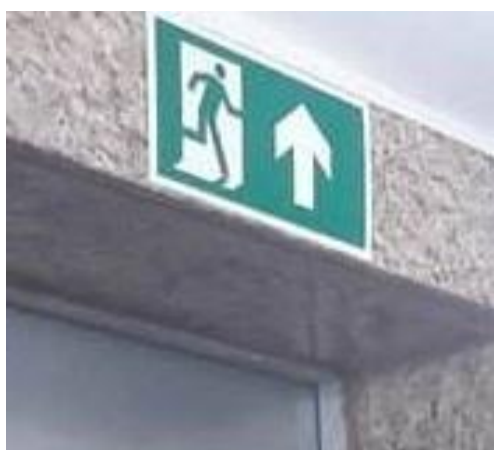
Figura 64 – Sinalização indicando a entrada na compartimentação vertical
