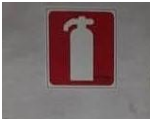
Figura 58 – Sinalização indicando extintor
