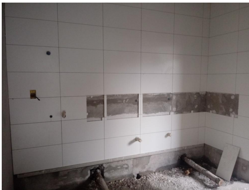
Figura 21 – Recorte em revestimento
