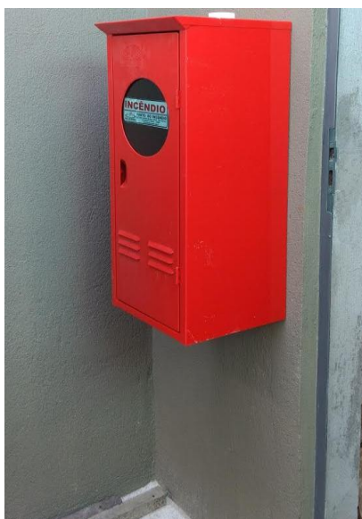
Figura 57 – Extintor com abrigo
