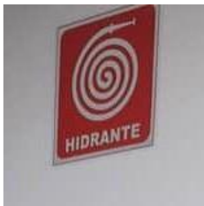
Figura 62 – Sinalização indicando hidrante
