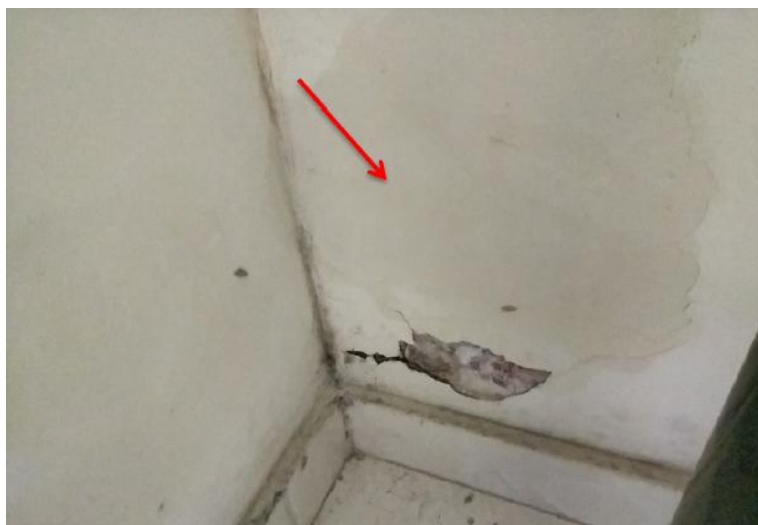
Figura 48 - Umidade ascendente e deslocamento da pintura (Casa 1)
