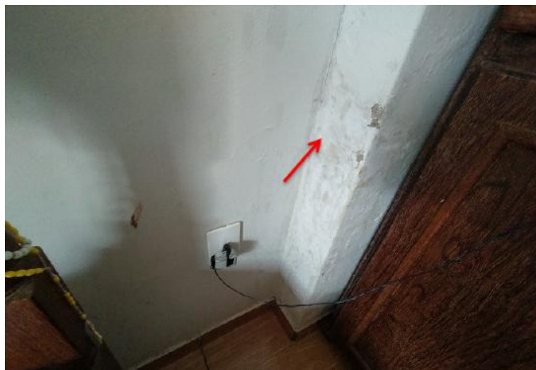
Figura 49 - Umidade ascendente e deslocamento da pintura (Casa 2)
