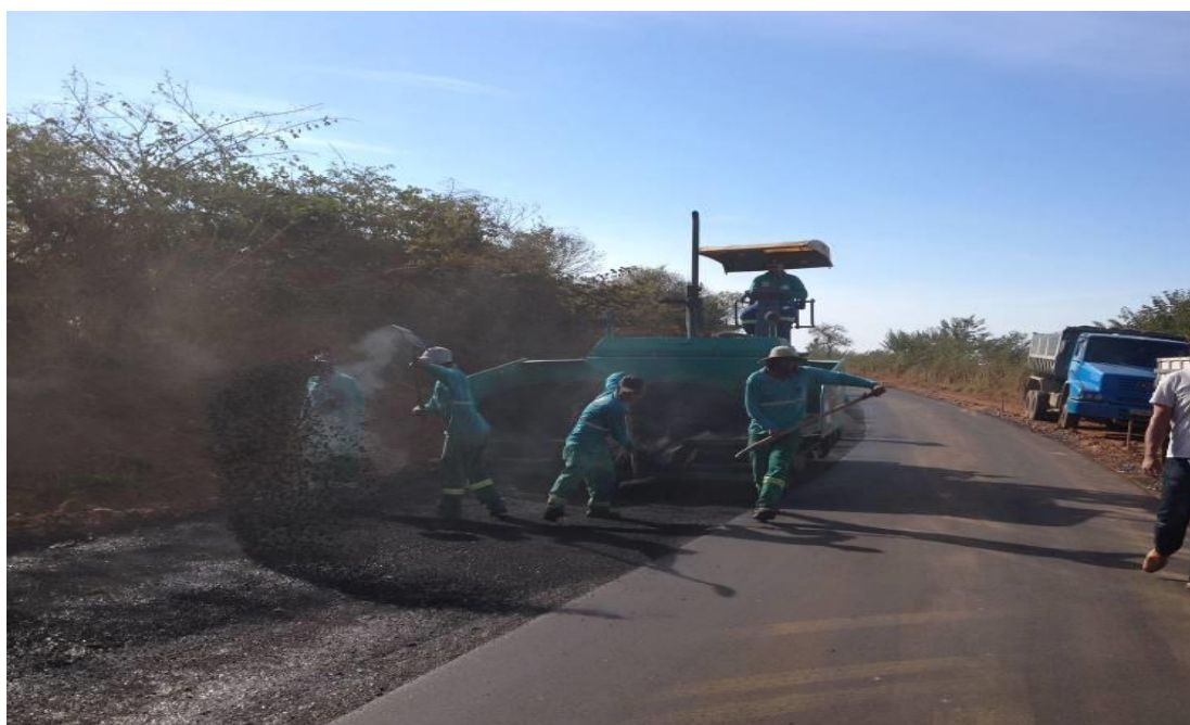
Figura 52 - Salgamento sobre uma das faixas da estrada vicinal do Rosário
