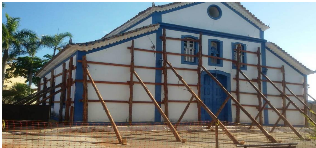
Figura 21 - Igreja de Nossa Senhora do Rosário, completamente escorada
