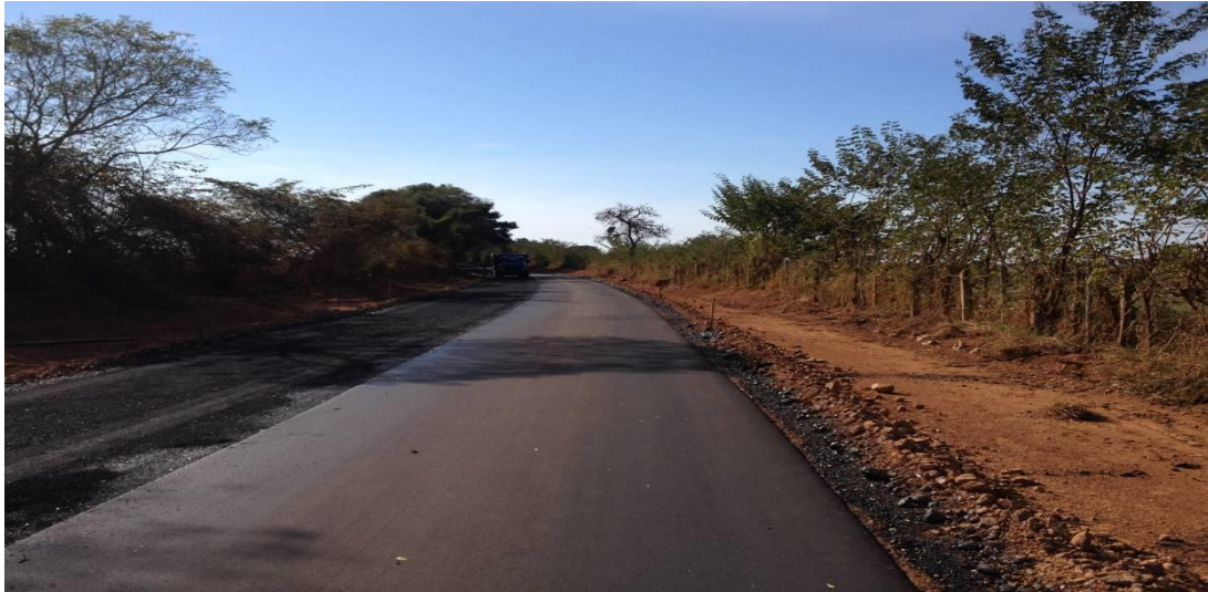
Figura 53 - Salgamento sobre uma das faixas da estrada vicinal do Rosário
