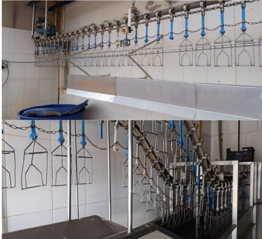
Figura 5: Equipamentos comuns às áreas externa e interna de um abatedouro frigorífico de aves.
