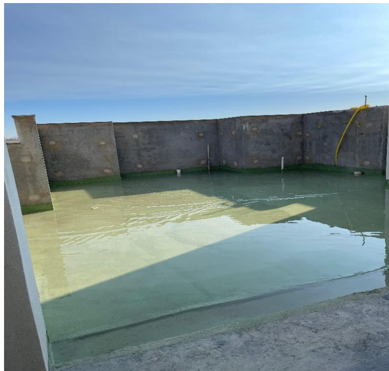
Figura 48 - Teste de estanqueidade.
