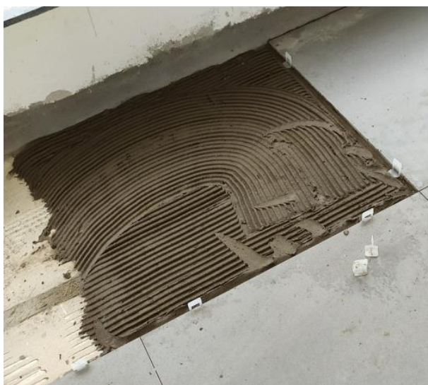
Figura 86: Argamassa na superfície do piso
