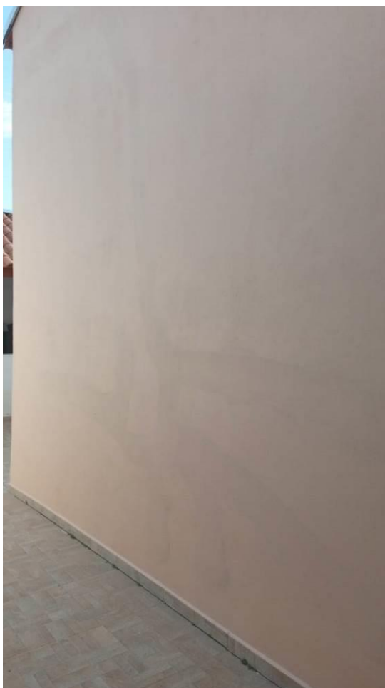
Figura 34 - Parede Pintada- Parede 2
