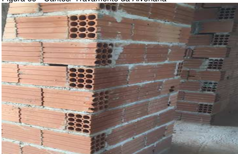
Figura 69 - Cantos/ Travamento da Alvenaria
