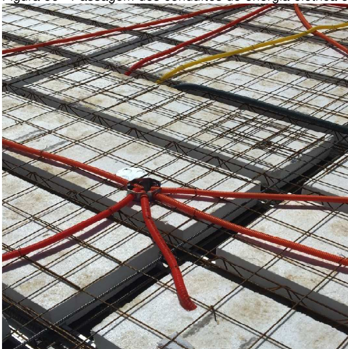
Figura 56 - Passagem dos conduítes de energia elétrica e telefonia
