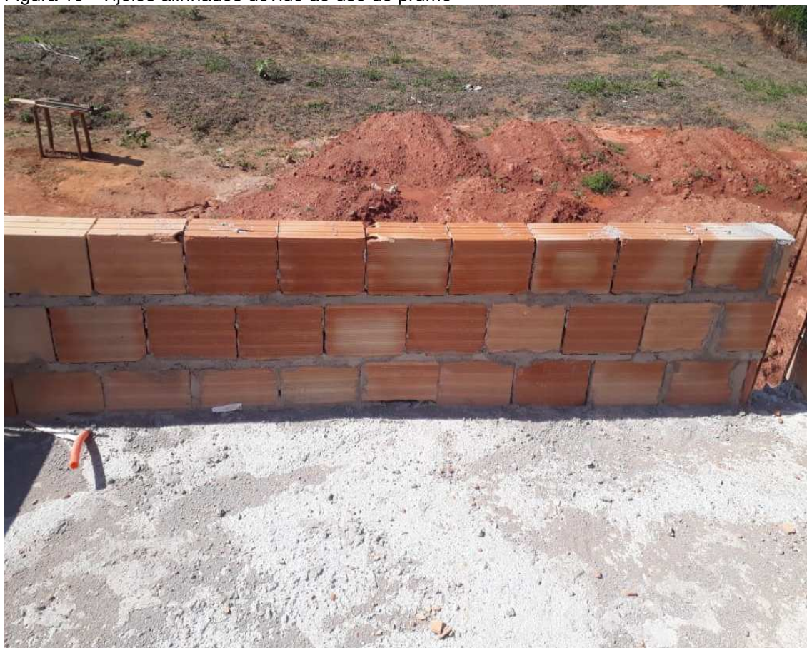
Figura 19 –Tijolos alinhados devido ao uso do prumo
