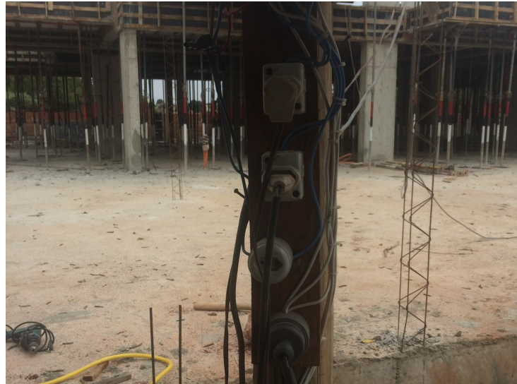
Figura 123 – A Instalações elétricas
