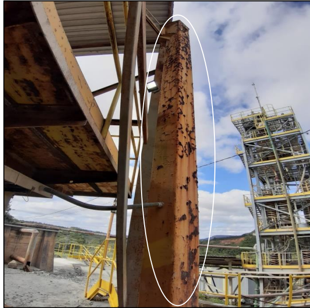
Figura 9 – Patologia da estrutura
