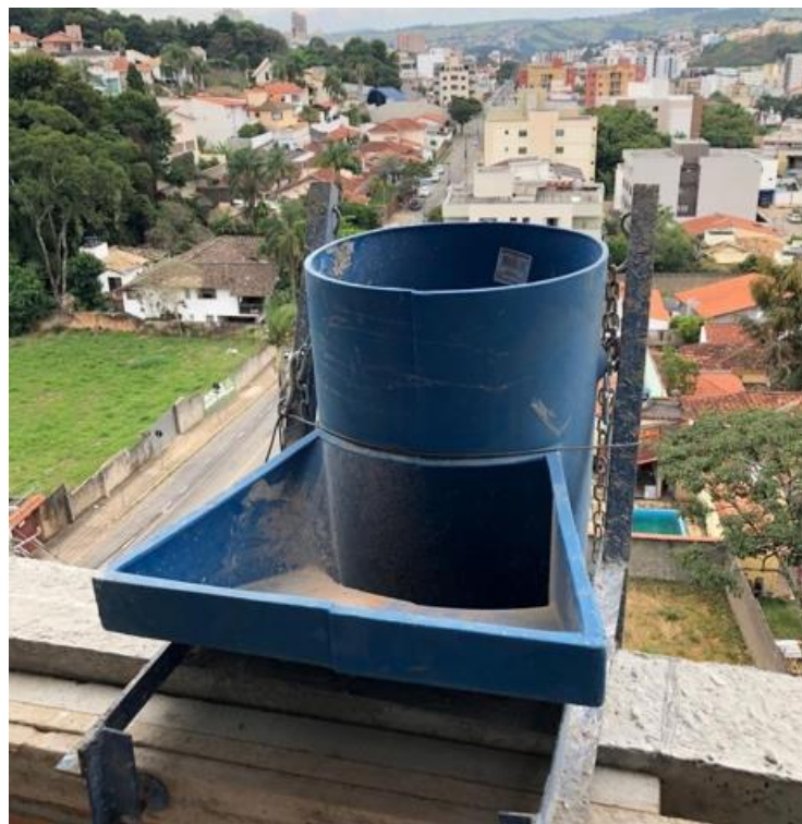
Figura 114 – Duto para entulho
