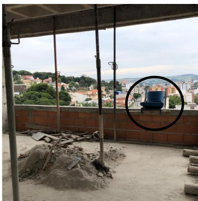
Figura 113 – Parede externa com duto de entulho
