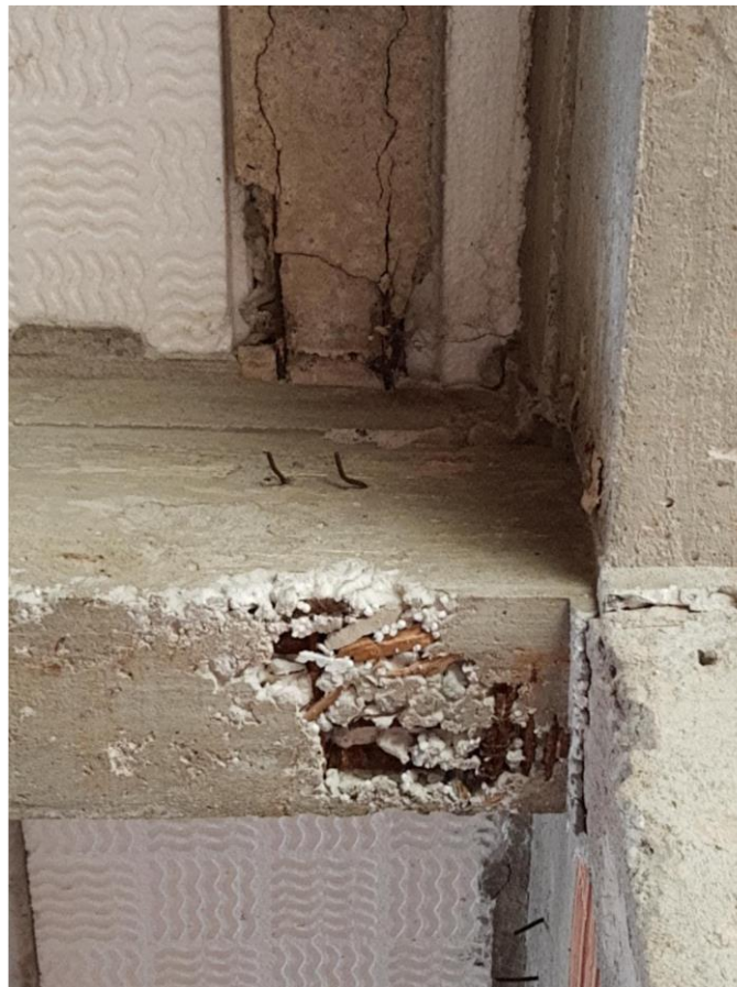
Figura 39 – Desplacamento na vigota
