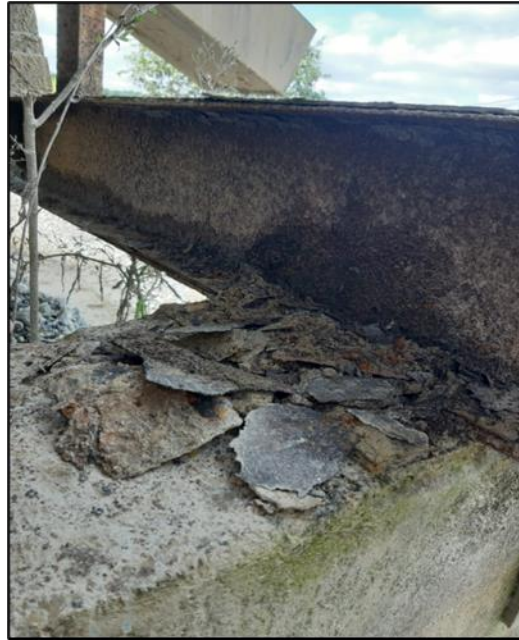
Figura 11 – Corrosão e perda de massa
