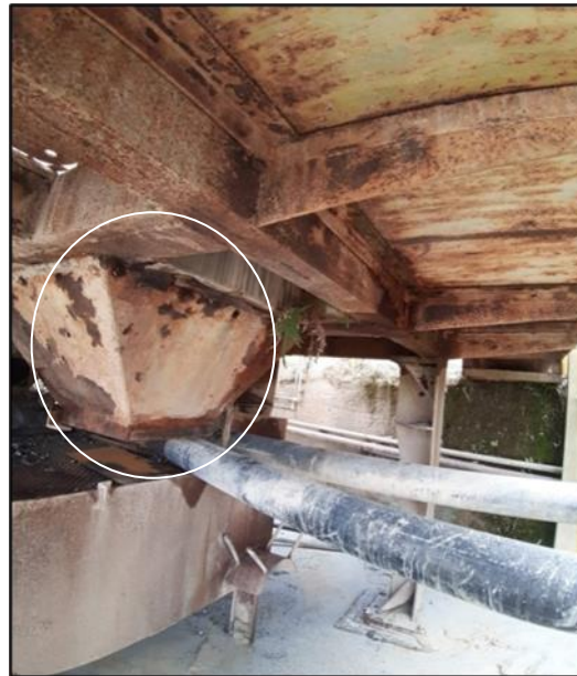
Figura 10 – Corrosão de metal
