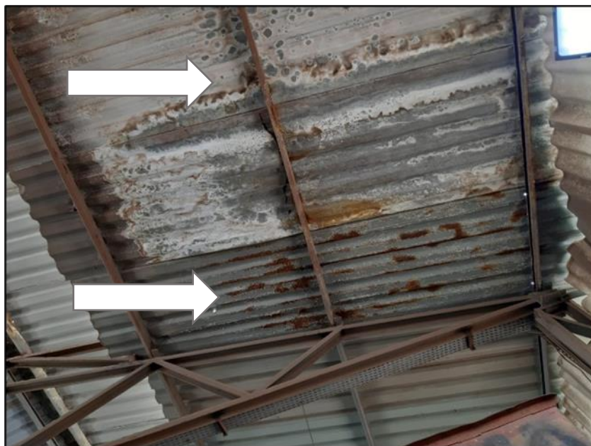
Figura 6 – Perfis metálicos com um nível de corrosão
