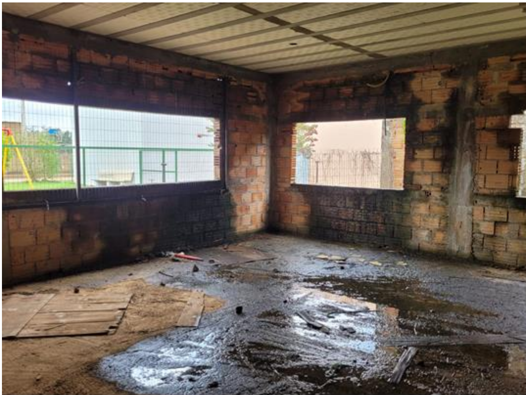
Figura 38 – Infiltração em sala de aula
