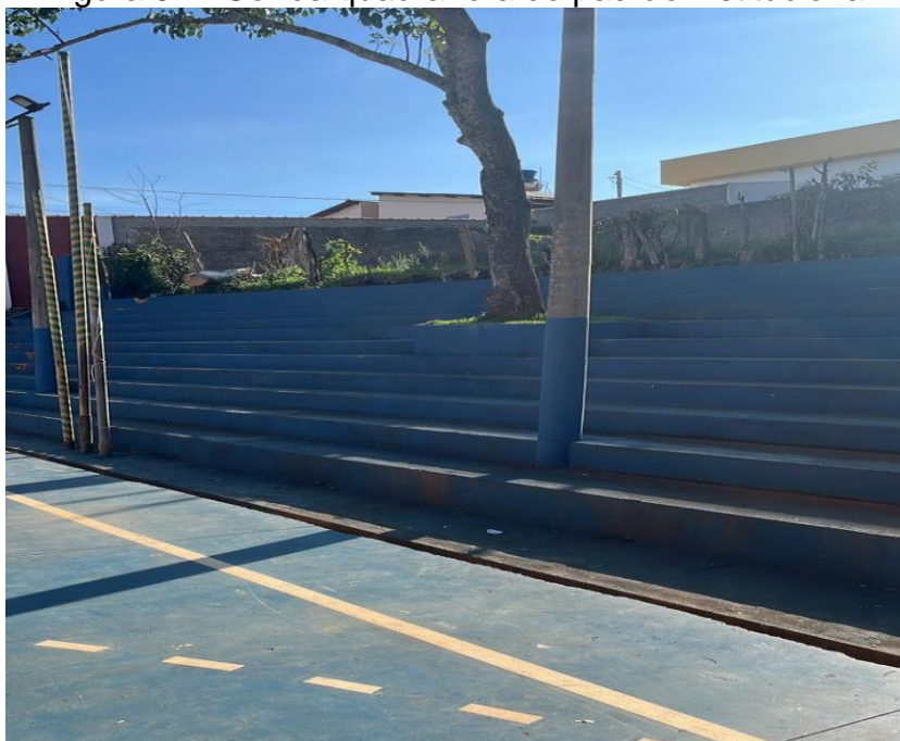
Figura 97 - Cor da quadra fora do padrão institucional
