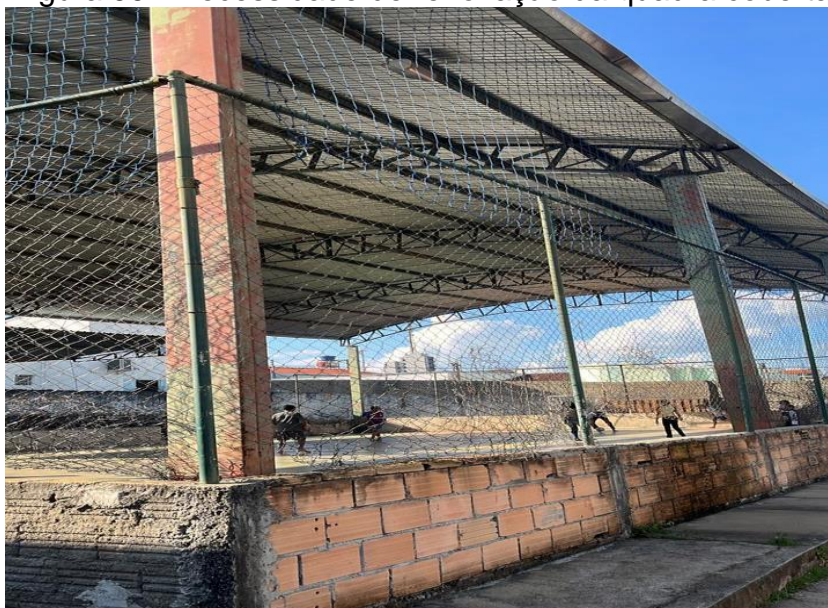
Figura 99 - Necessidade de renovação da quadra coberta
