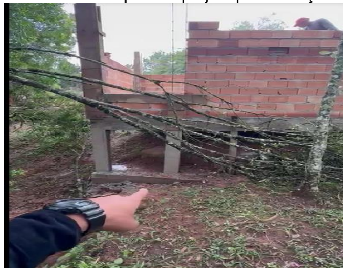
Figura 123 - Inclusão de um pilar ao projeto para reforçar o vão de porta
