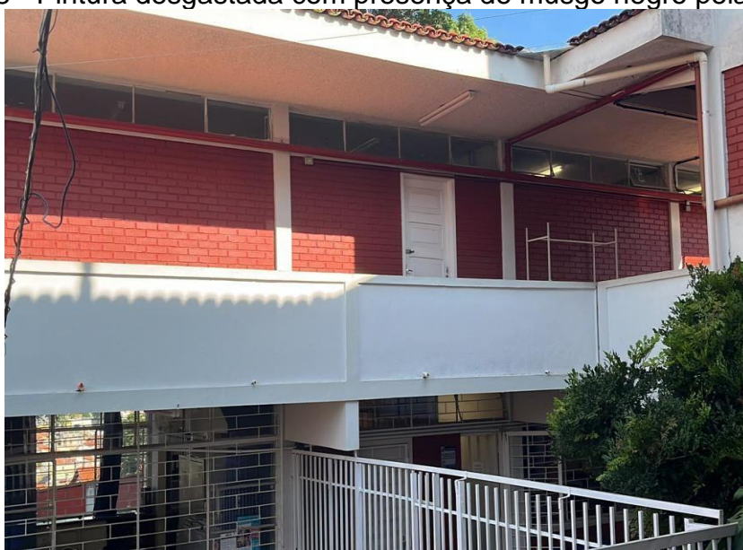
Figura 98 - Pintura desgastada com presença de musgo negro pela umidade
