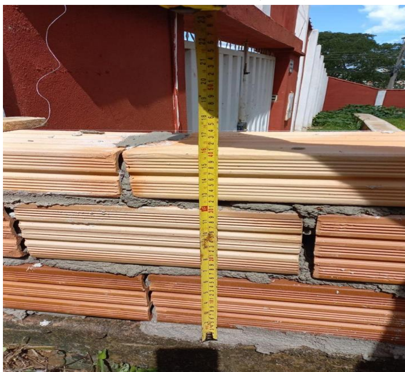
Figura 106 - Necessidade de reforço do guarda-corpo
