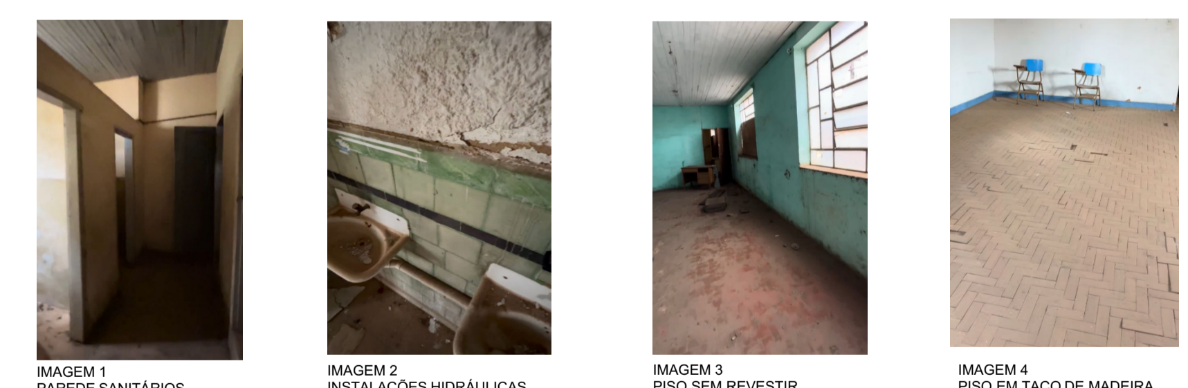
IMAGEM 1 PAREDE SANITÁRIOS IMAGEM 2 INSTALAÇÕES HIDRÁULICAS IMAGEM 3 PISO SEM REVESTIR IMAGEM 4 PISO EM TACO DE MADEIRA
