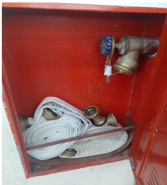
Figura 57 – Hidrantes e seus equipamentos
