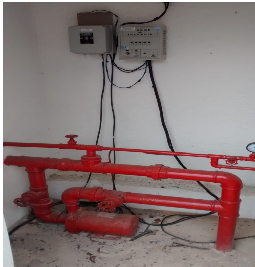
Figura 56 – Bomba de incêndio e sistema by-pass
