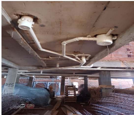
Figura 53 – Rede coletora de esgoto
