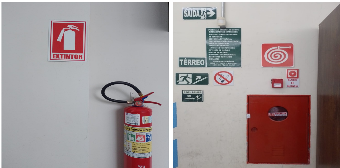
Figura 59 – Sinalização de emergência
