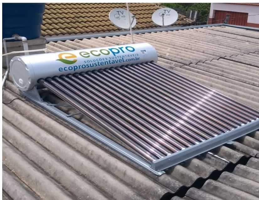
Figura 52 – Sistema de aquecimento por tubos à vácuo
