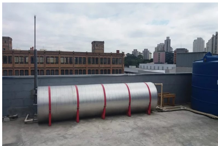
Figura 51 – Boiler utilizado para armazenar água quente
