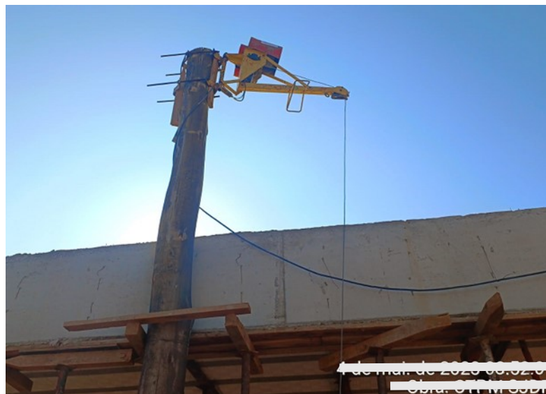
Figura 15 – Guincho central de argamassa
