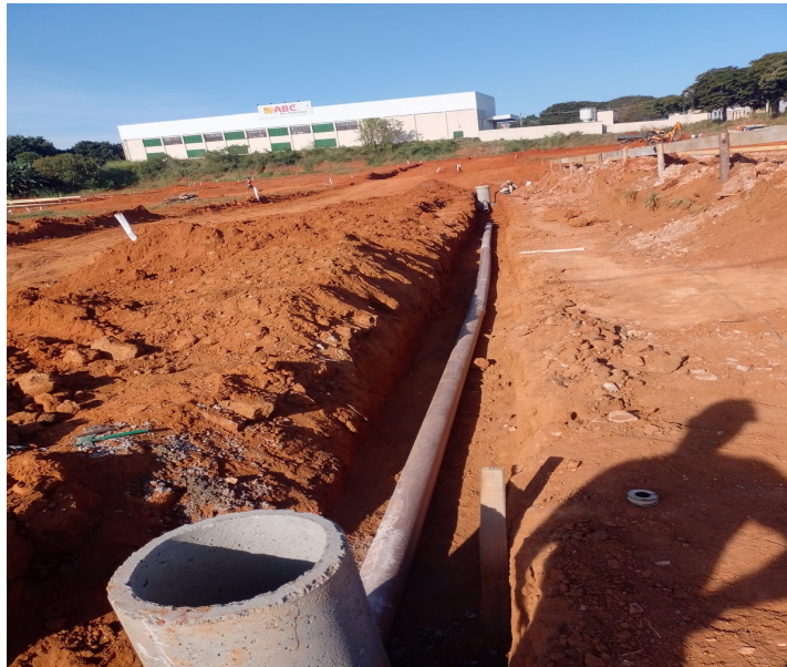
Figura 55 – Rede de captação
