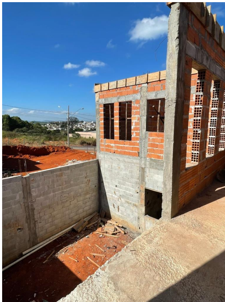
Figura 57: Diferença entre as alvenarias dos dois pavimentos
