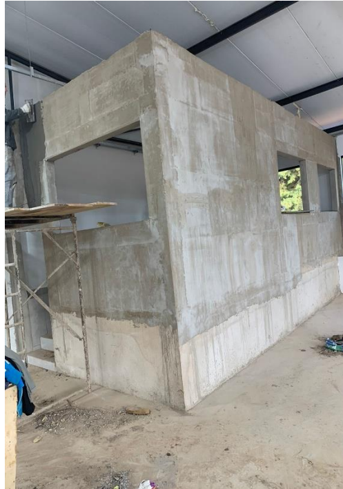
Figura 20: Reboco interno da marcenaria Fadminas.
