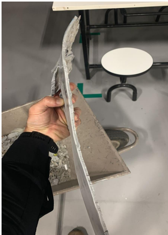
Figura 5: Fragmento de piso danificada por má realização da mistura
