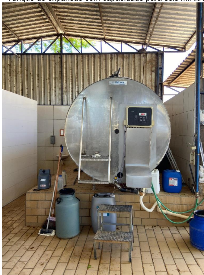
Figura 9 – Tanque de expansão com capacidade para seis mil litros de leite.
