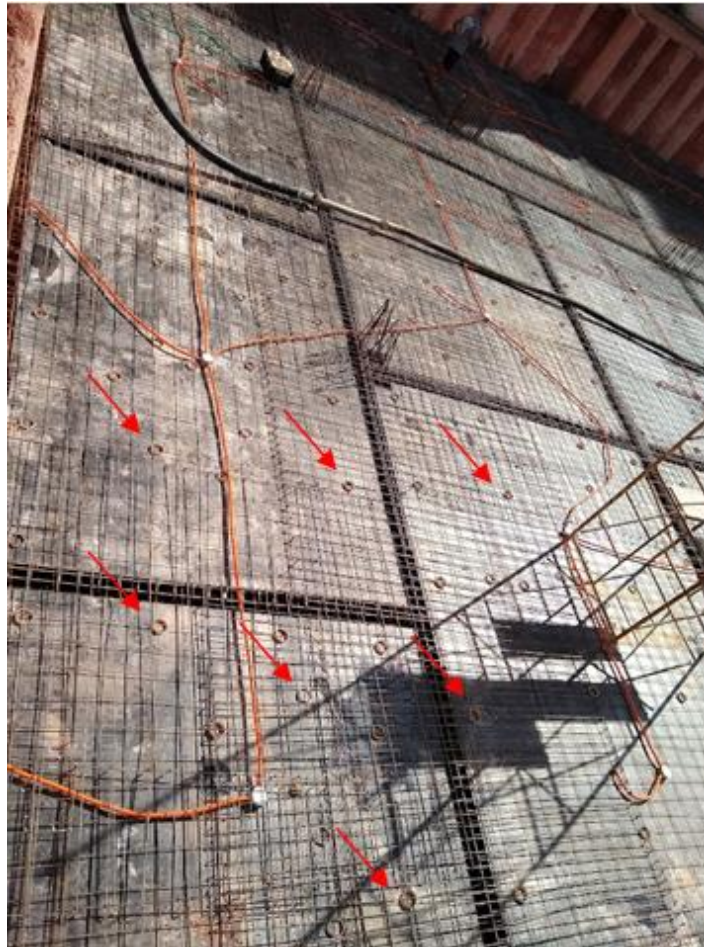
Figura 75 – Presença de espaçadores em laje
