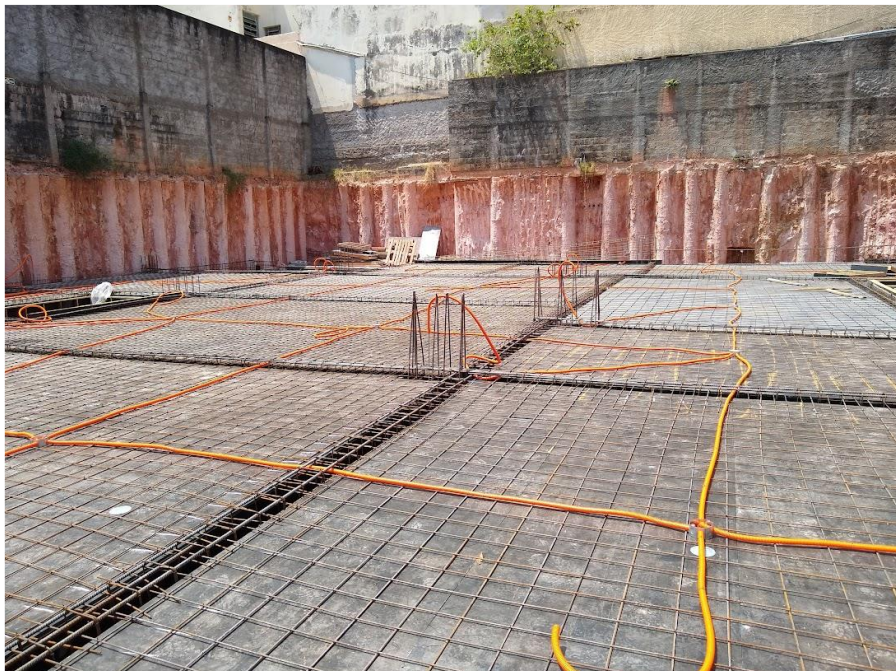
Figura 73 – Eletrodutos e caixas de passagem em laje
