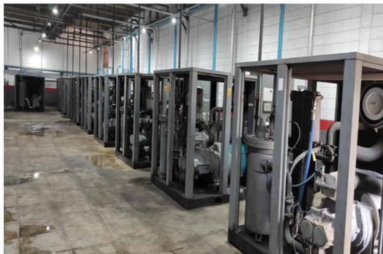
Figura 14. Compressores Atlas Copco.
