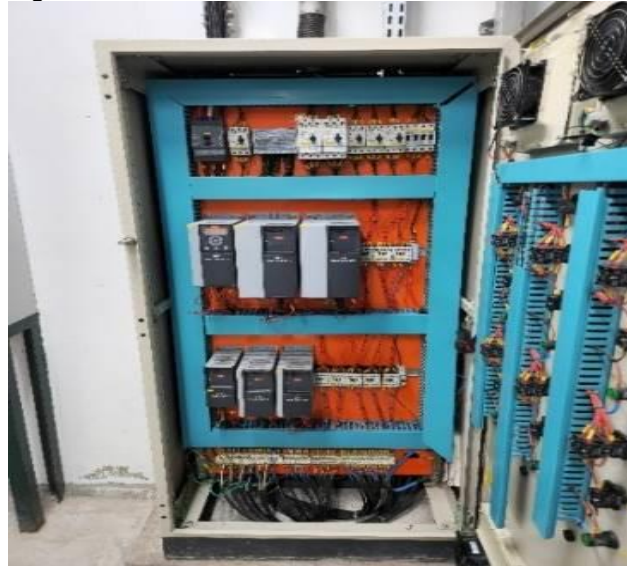
Figura 12 - Painel do climatizador da área de envase
