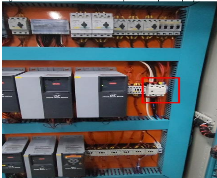
Figura 14 - Painel do climatizador após alteração do projeto
