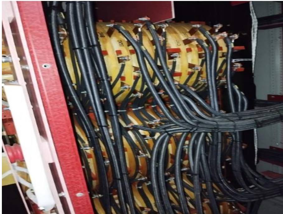
Figura 11 -Transformador a seco 6,6kVac/600Vac com múltiplos secundários.
