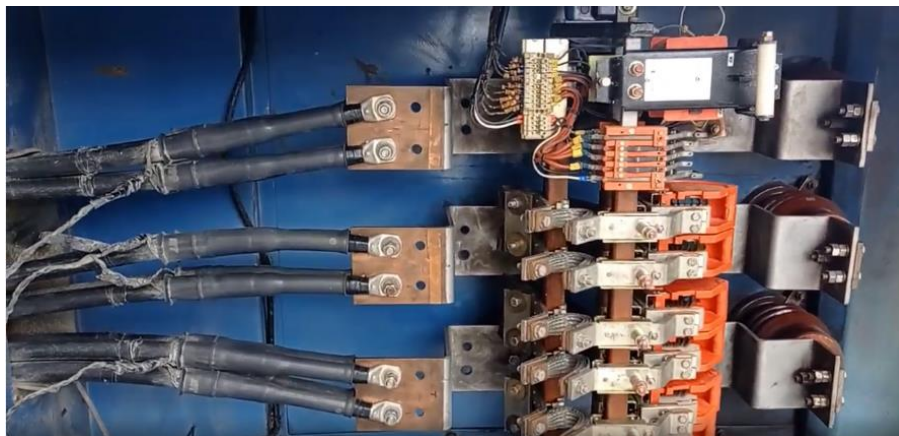
Figura 08 - Hidroeostato de partida de motor de 6,6kVac, 2.180KW
