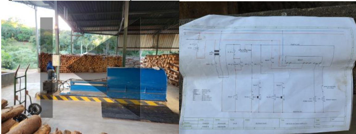
Figura 16 - Sistema elétrico da máquina de corte hidráulico de madeira
