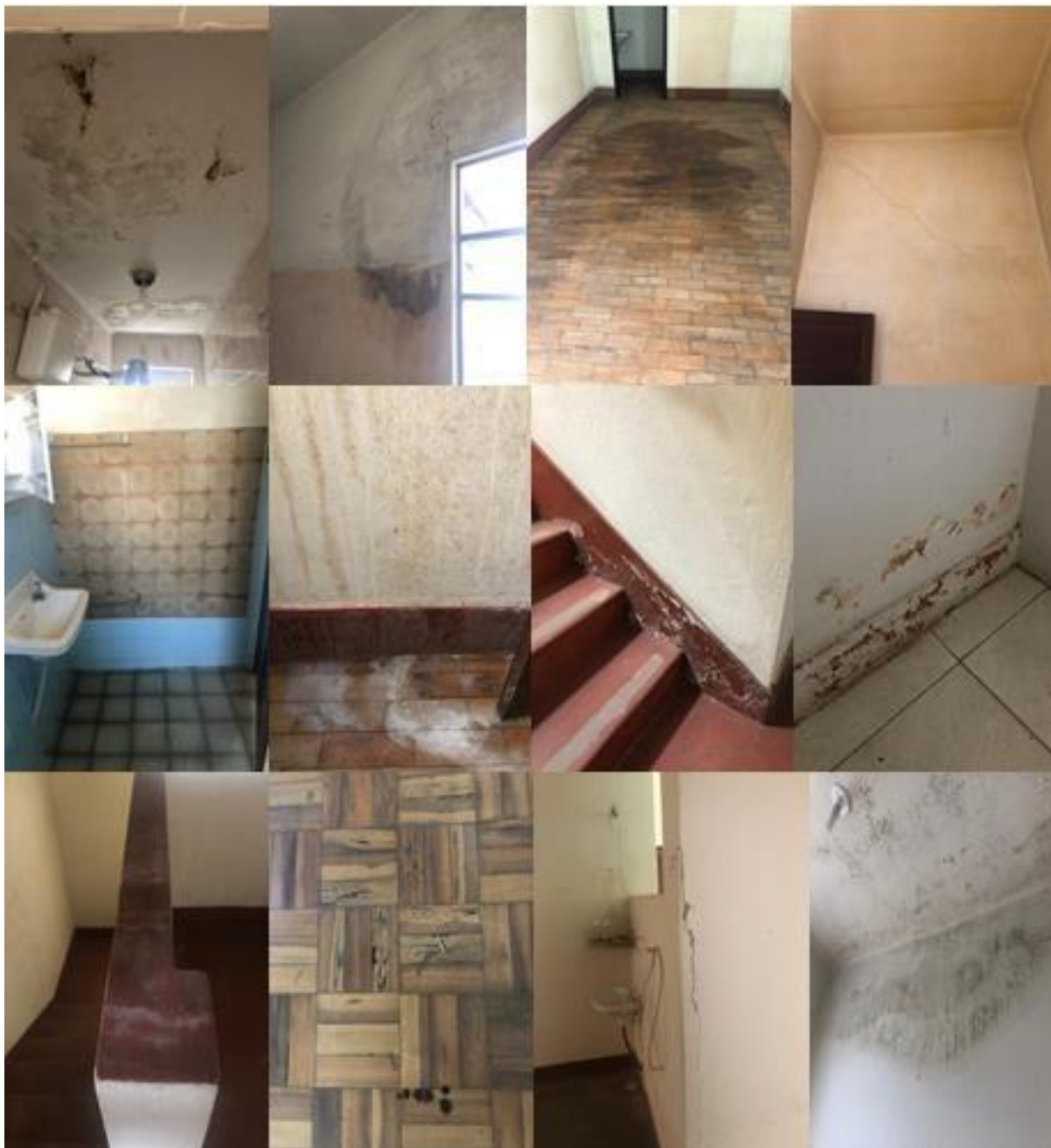
Imagem 19 - Danos internos no Mosteiro São José
