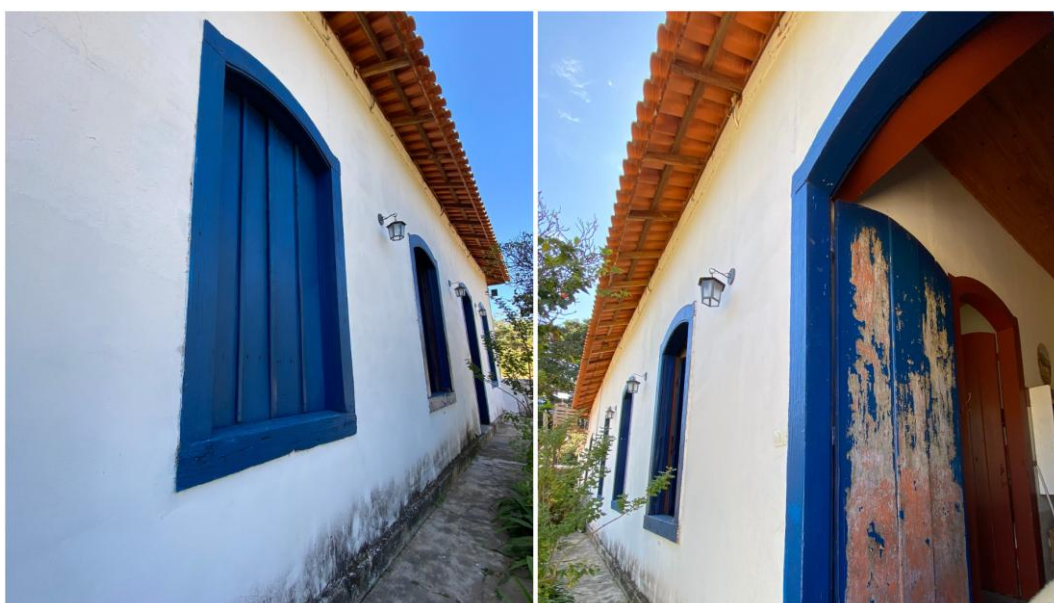
Imagem 29: Fachada frontal, evidenciando as manchas mofo e danos nas esquadrias.
