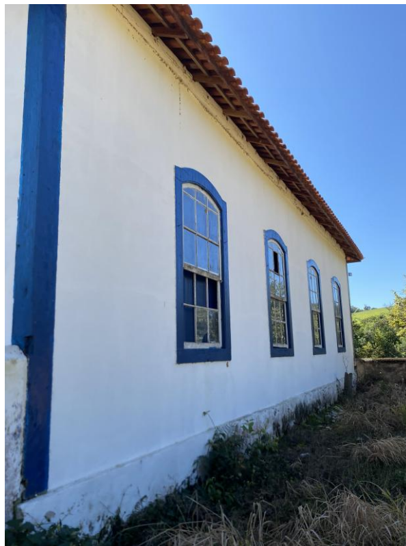
Imagem 30: Fachada sul, evidenciando os vidros faltantes ou quebrados
