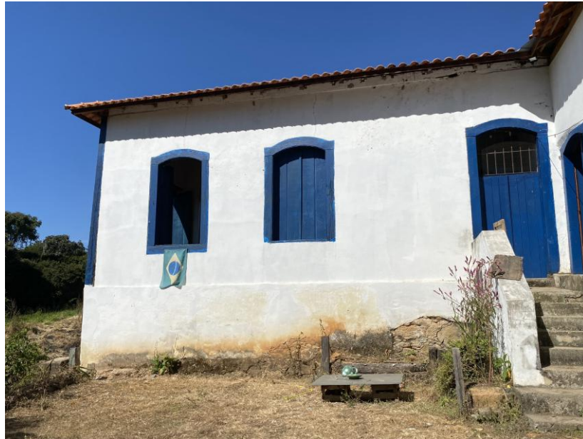
Imagem 15: Fachada sul, evidenciando os vidros faltantes ou quebrados
