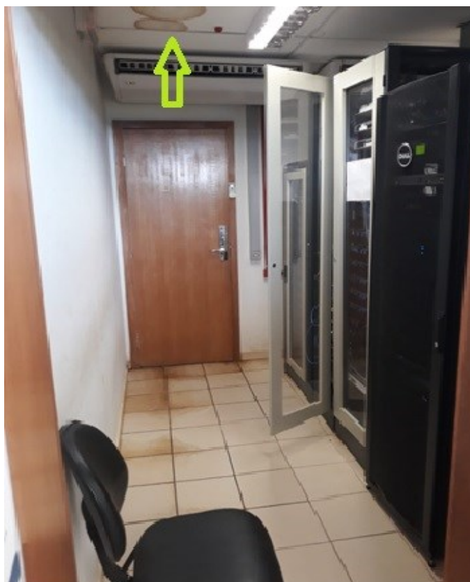
Figura 87 - Mofo no forro mineral.
