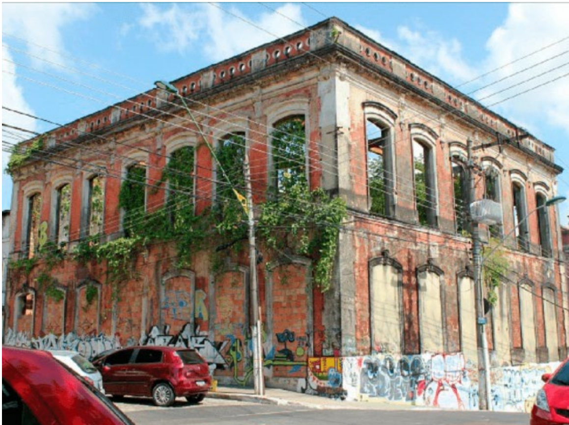
Imagem 8 – Edificação tomada por abandono
