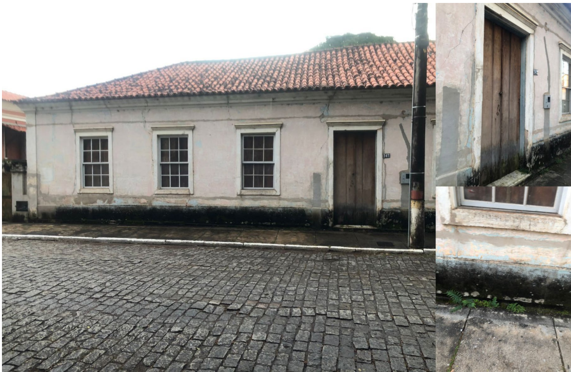
Imagem 12 – Fachada frontal e patologias
