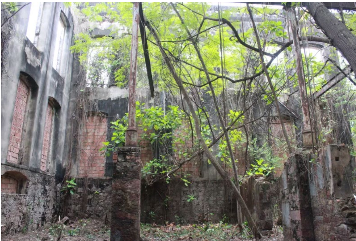
Imagem 10 – Estado de ruína
