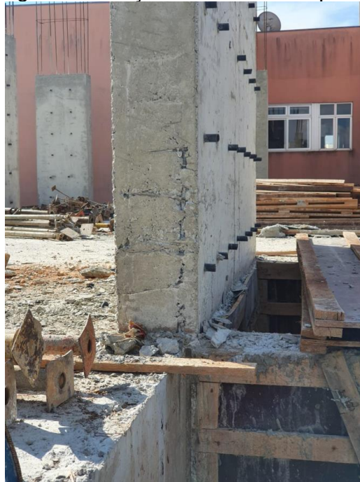
Figura 97 – Aço da armadura exposto
