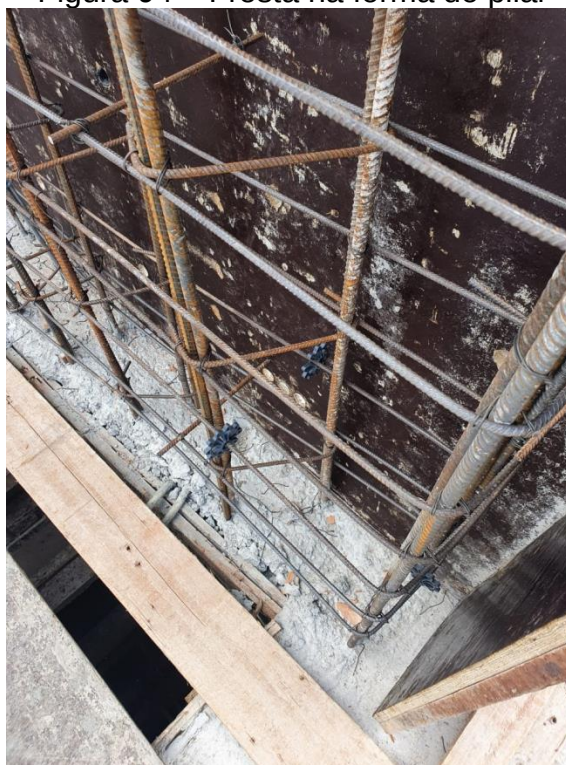
Figura 94 – Fresta na fôrma do pilar
