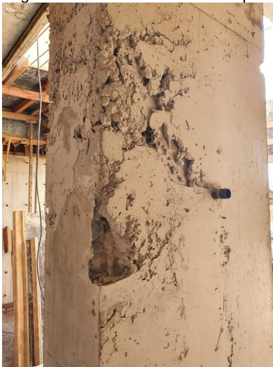
Figura 95 – Vazios formados no pilar
