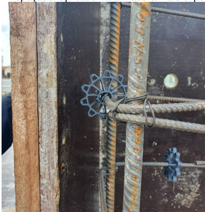
Figura 89 – Espaçador aplicado na armadura mais exposta do pilar
