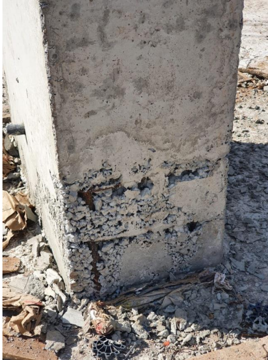
Figura 96 – Aço da armadura exposto
