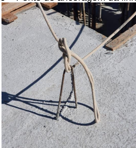
Figura 56 – Ponto de ancoragem da linha de vida
