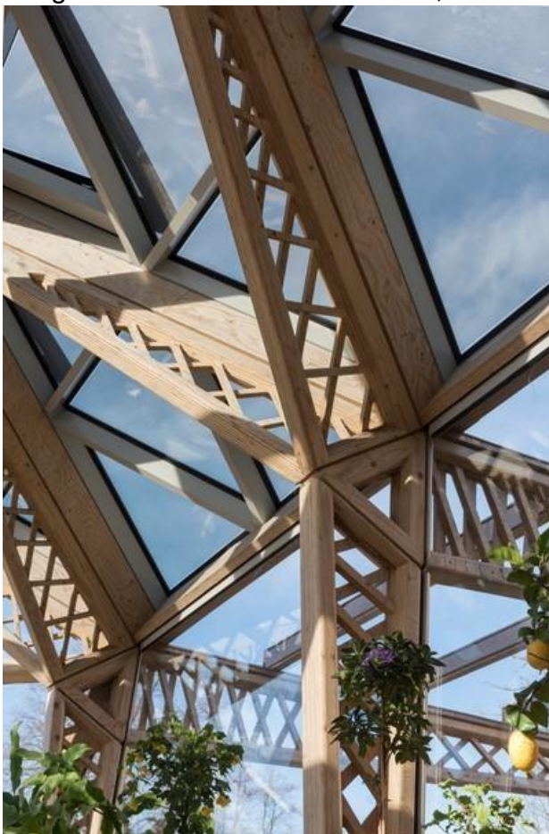
Imagem 21: Estrutura em madeira, sem fixação aparente.
