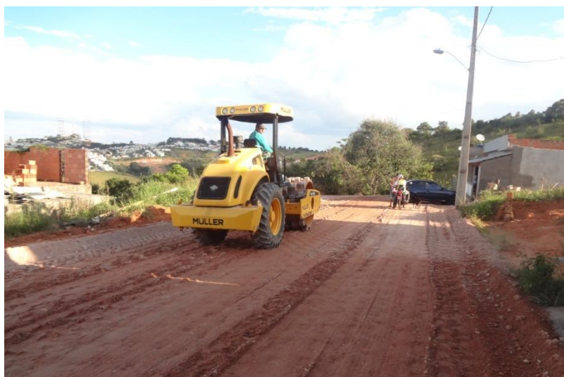
Figura 65 - Compactação do solo
