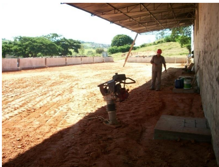
Figura 57 - Compactação do solo
