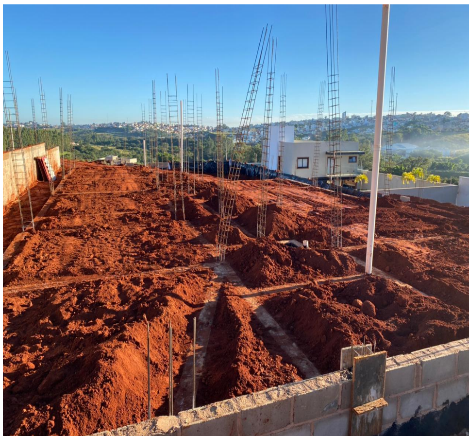
Figura 37 - Compactação do solo
