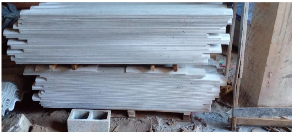
Figura 31 - Armazenamento de telha de fibrocimento
