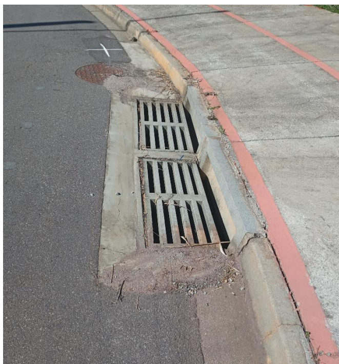
Figura 79 – Boca de lobo
