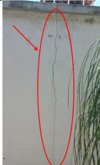
Figura 5 - Fissura em parede
