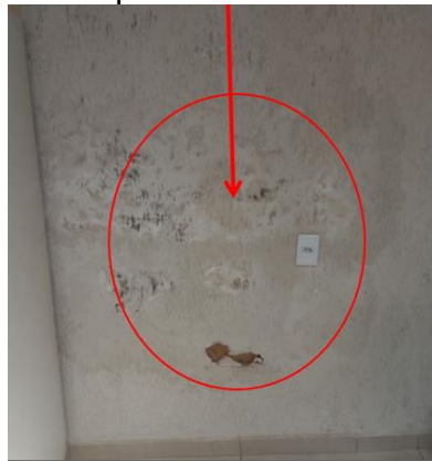
Figura 7 - Deslocamento do revestimento
