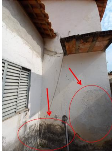
Figura 4 - Infiltração em parede
