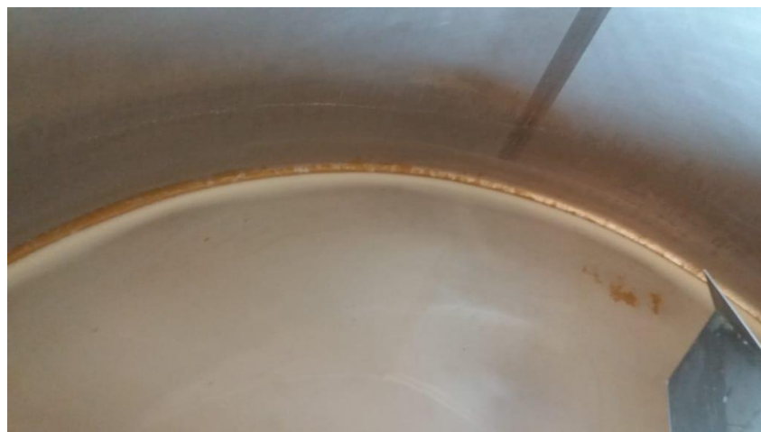
Foto 7: Tanque de expansão com formação de biofilme.
