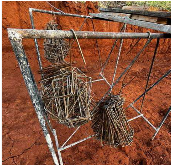
Figura 55 – Armazenamento dos estribos, distante do chão
