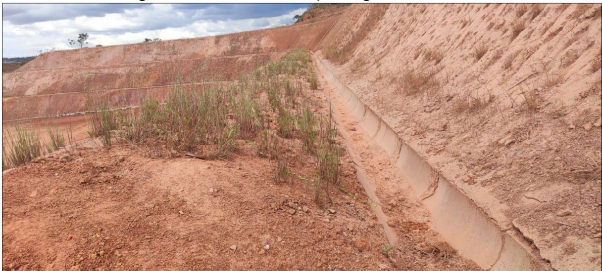
Figura 5 – Berma com inclinação irregular identificada
