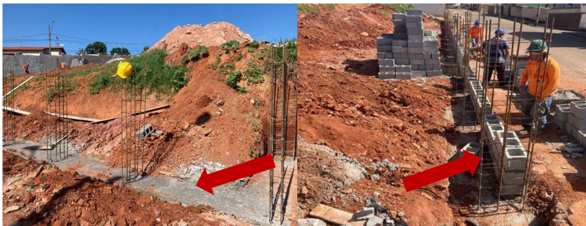
Figura 12 – Laje horizontal do muro de arrimo e armaduras colocadas para início de assentamento de tijolos
