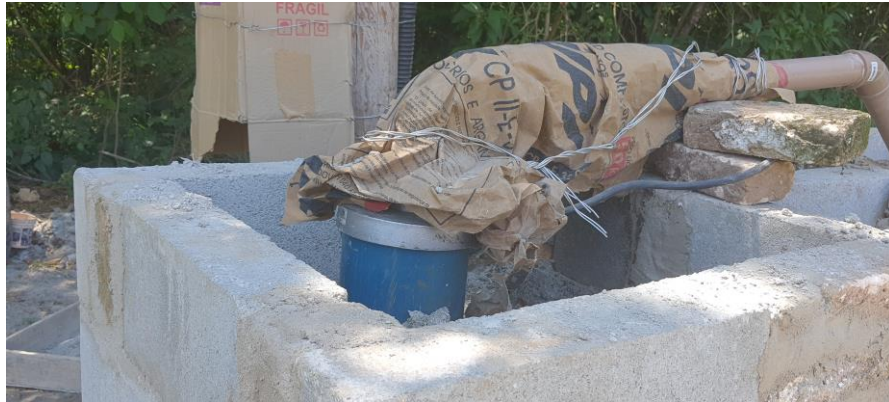
Figura 75 – Alimentação elétrica da bomba
