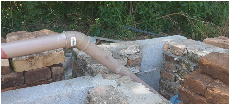
Figura 76 – Tubulação de recalque da bomba
