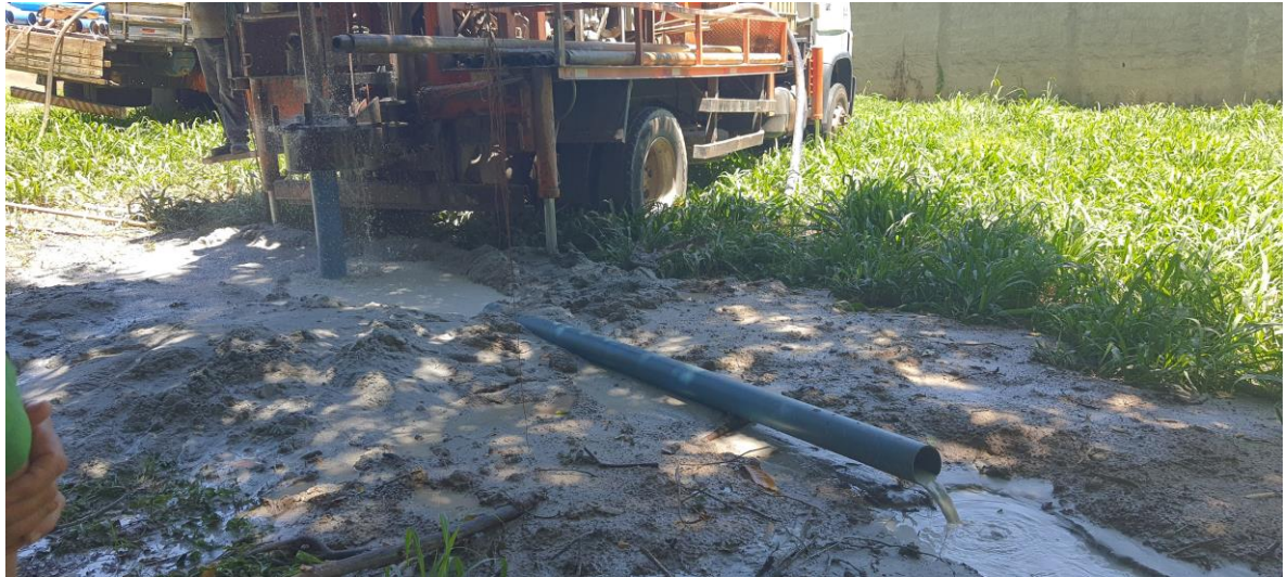
Figura 70 – Tubulação do ponto perfuração até a saída da água do poço
