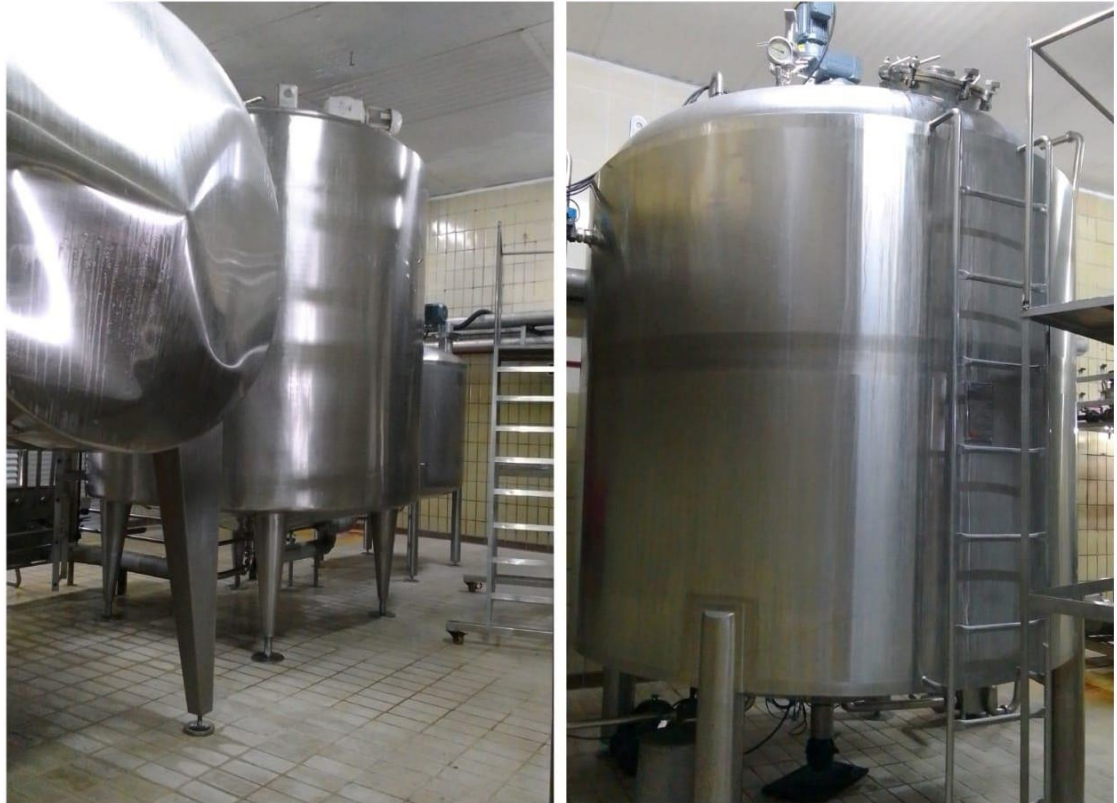
Figura 4: Tanques para armazenamento resfriado
